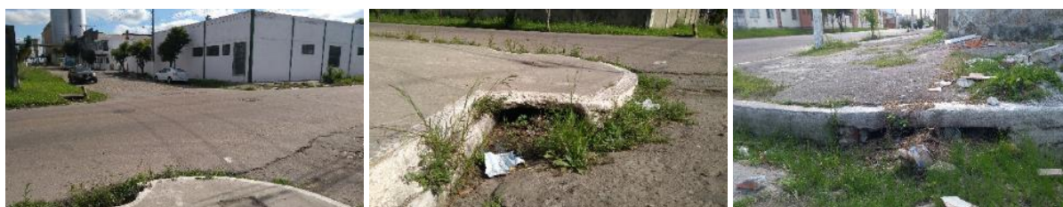
Figura 3: Bocas de lobo localizadas em alguns pontos de alagamentos no bairro Porto. Imagens produzidas em outubro de 2018.
