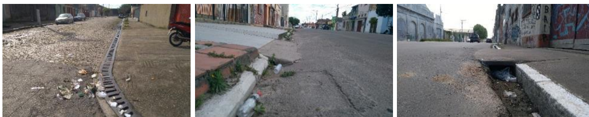
Figura 15: Fotografias de rampas de garagem inadequadas por obstruírem o escoamento e/ou impedirem a varrição da sarjeta. Imagens de outubro/2018.
