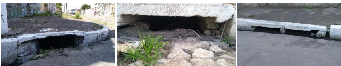
Figura 6: Bocas de lobo do bairro Porto em condições adequadas para funcionamento. Imagens produzidas em outubro de 2018.
