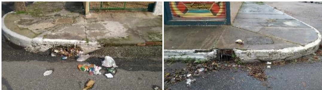
Figura 7: Bocas de lobo com grade no bairro Porto. Imagens produzidas em setembro de 2018.
