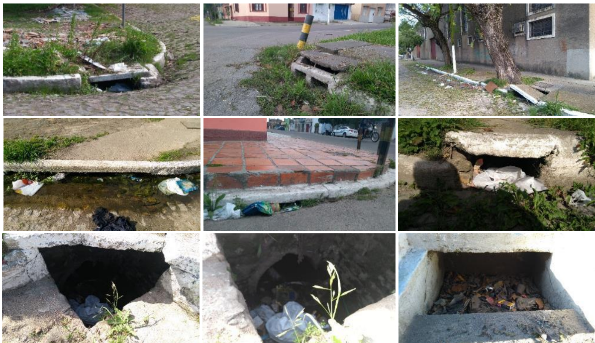
Figura 5: Bocas de lobo do bairro Porto que necessitam de reparos e limpeza. Imagens produzidas em outubro de 2018.
